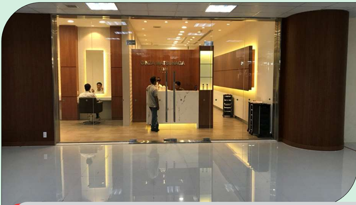
GINZA MATSUGANA. Thiết kế, thi công hệ thống cơ điện/ Design and installation the M&E systems.
